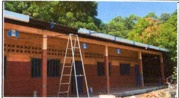
FOTO 8: Sustrucción de canal de metal
